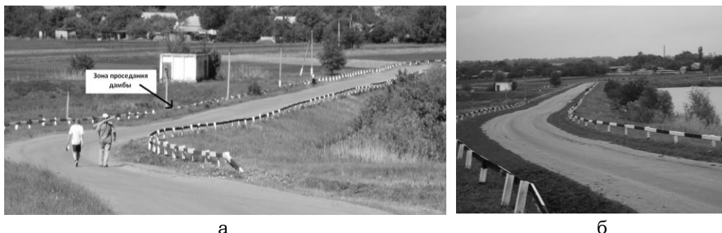
а б Рисунок 2 - Вид дамбы Великомихайловского водохранилища: а - в мае 2011 г.; б - в октябре в 2013 г. (хорошо видно развитие процессов проседания и сползания почвы по положению дорожного отбойника)
